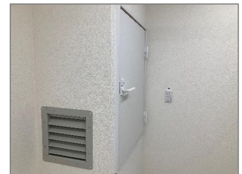
図 コンテナ内部の陰圧装置
