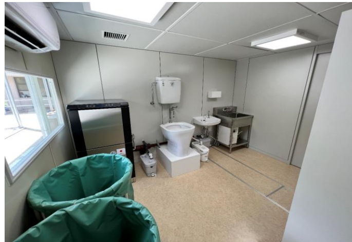
医療廃棄物、汚物処理室
