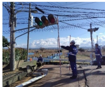
道路の被災状況調査 (石川県内灘町)
