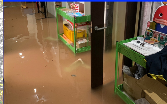
屋内浸水状況（09/23 23:51）
