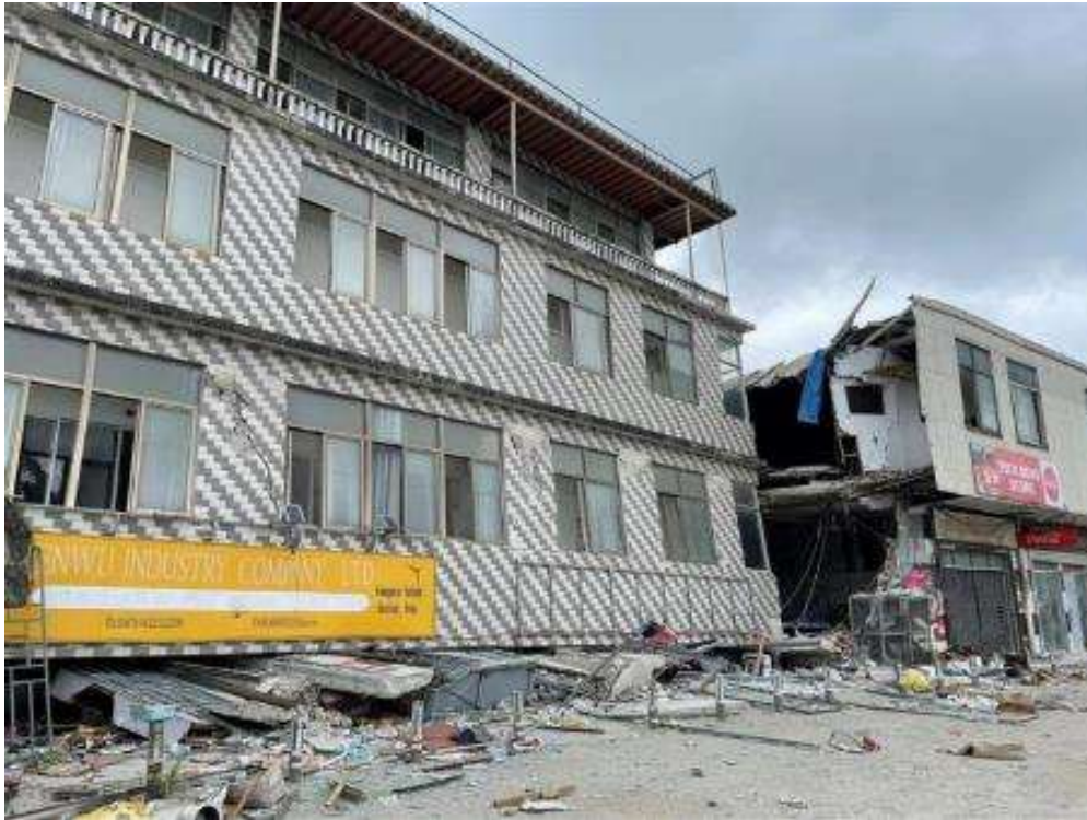
1階が押しつぶされた中華系ビル
