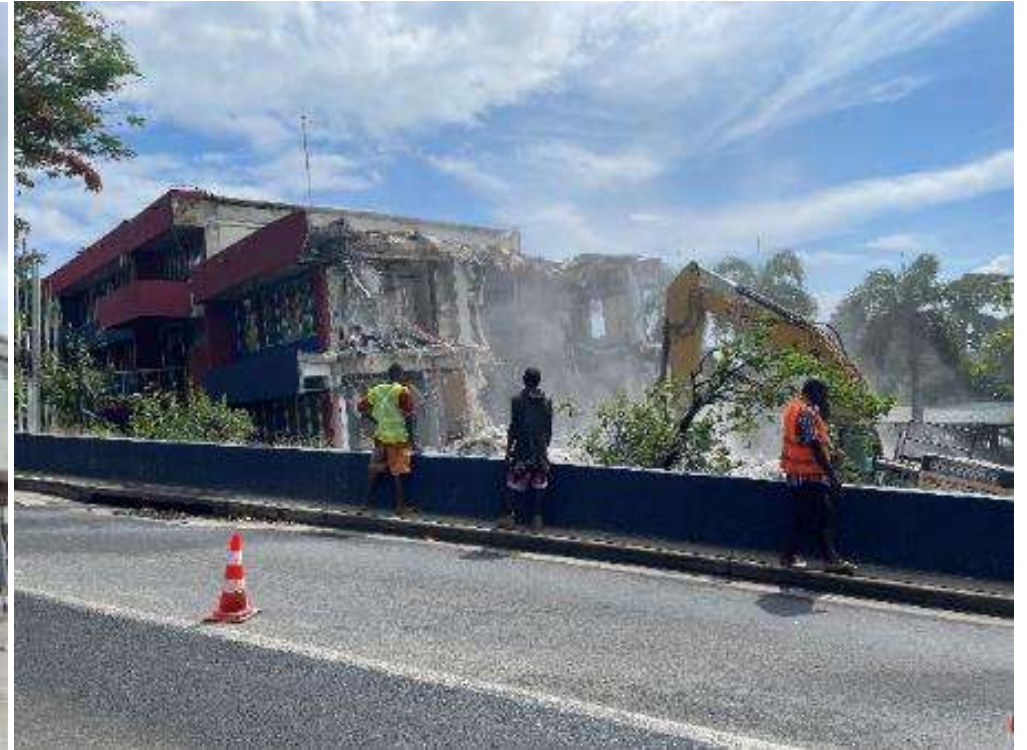
損壊により取り壊しが始まった米・英・ ニュージーランドの各国大使館が入居 していたビル
