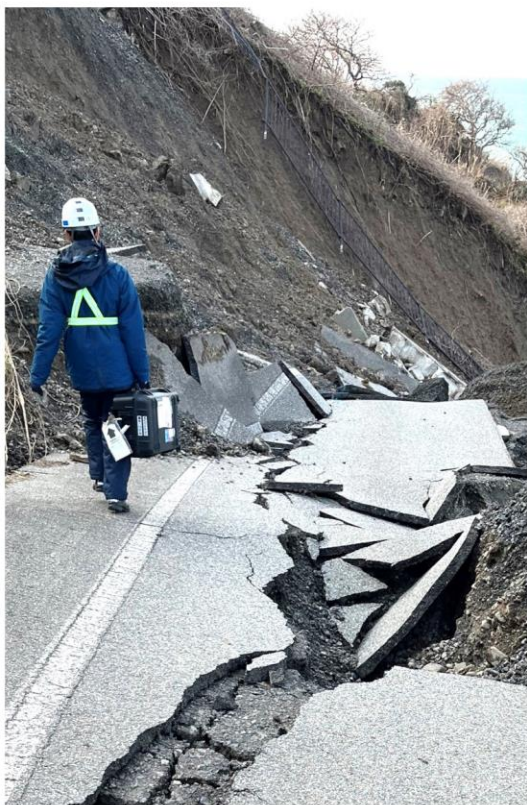
2024年1月 能登地震で道路崩壊
